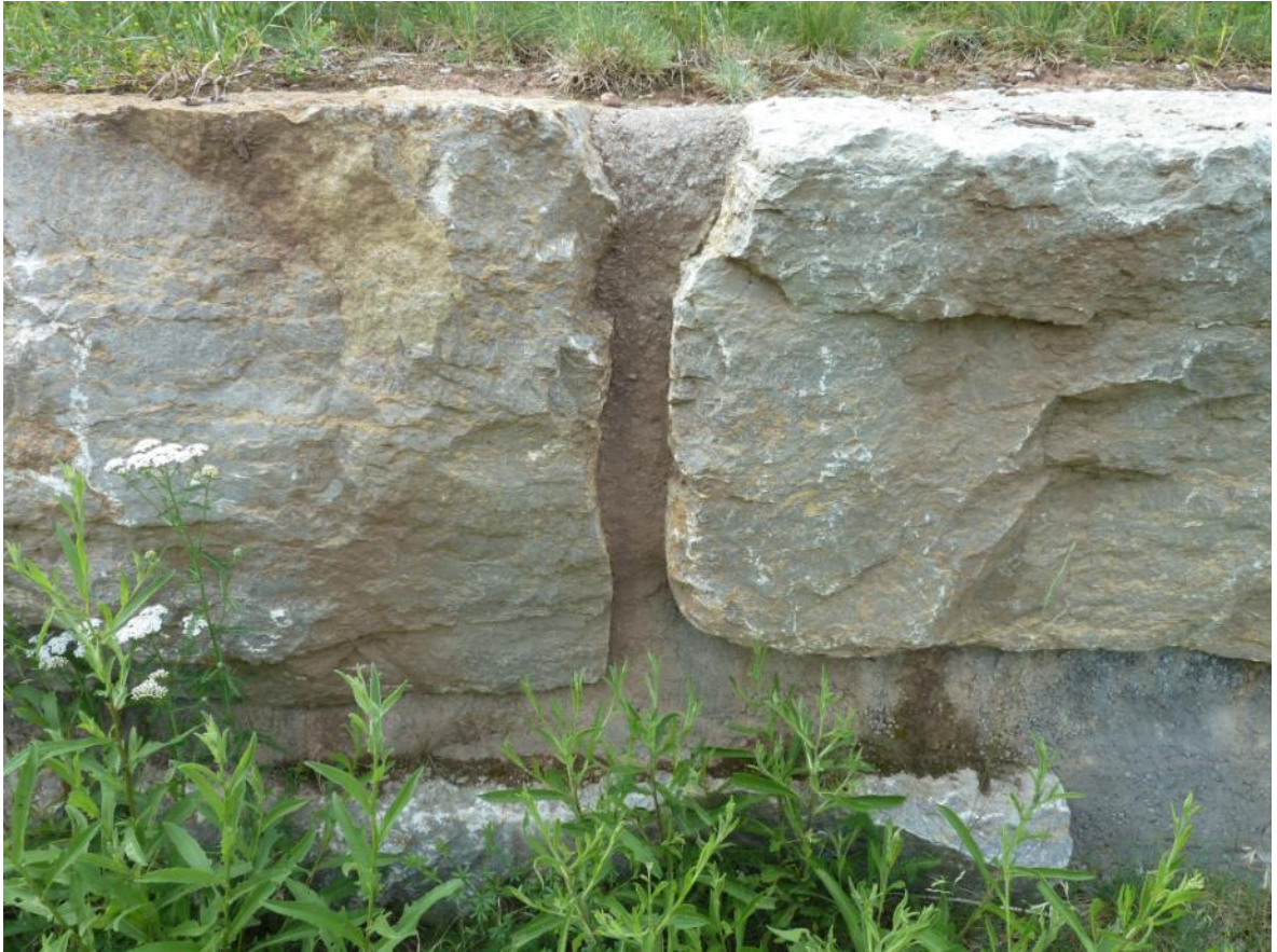
Abbildung 21 In solch verfugtem Zustand ist die Mauer für Eidechsen ohne Wert
