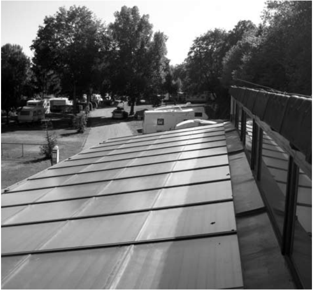
Solarthermieanlage am Campingplatz Tübingen
