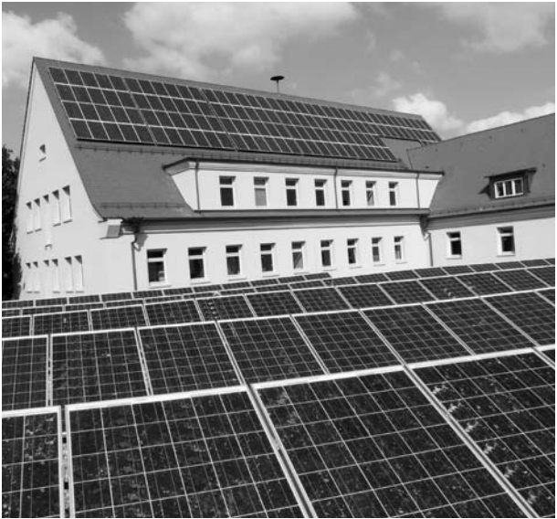
PV-Anlage auf dem Wildermuth-Gymnasium Tübingen
