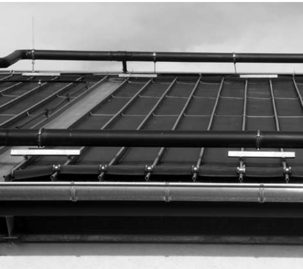
Nahaufnahme der Solarthermieanlage
