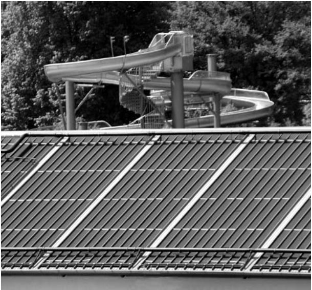
Solarthermieanlage im Freibad Tübingen
