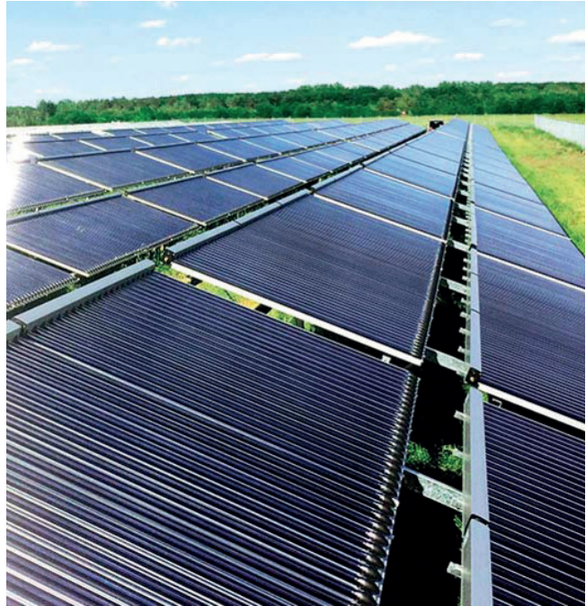
Bild: © Großanlage Senftenberg ©Ritter Energie
