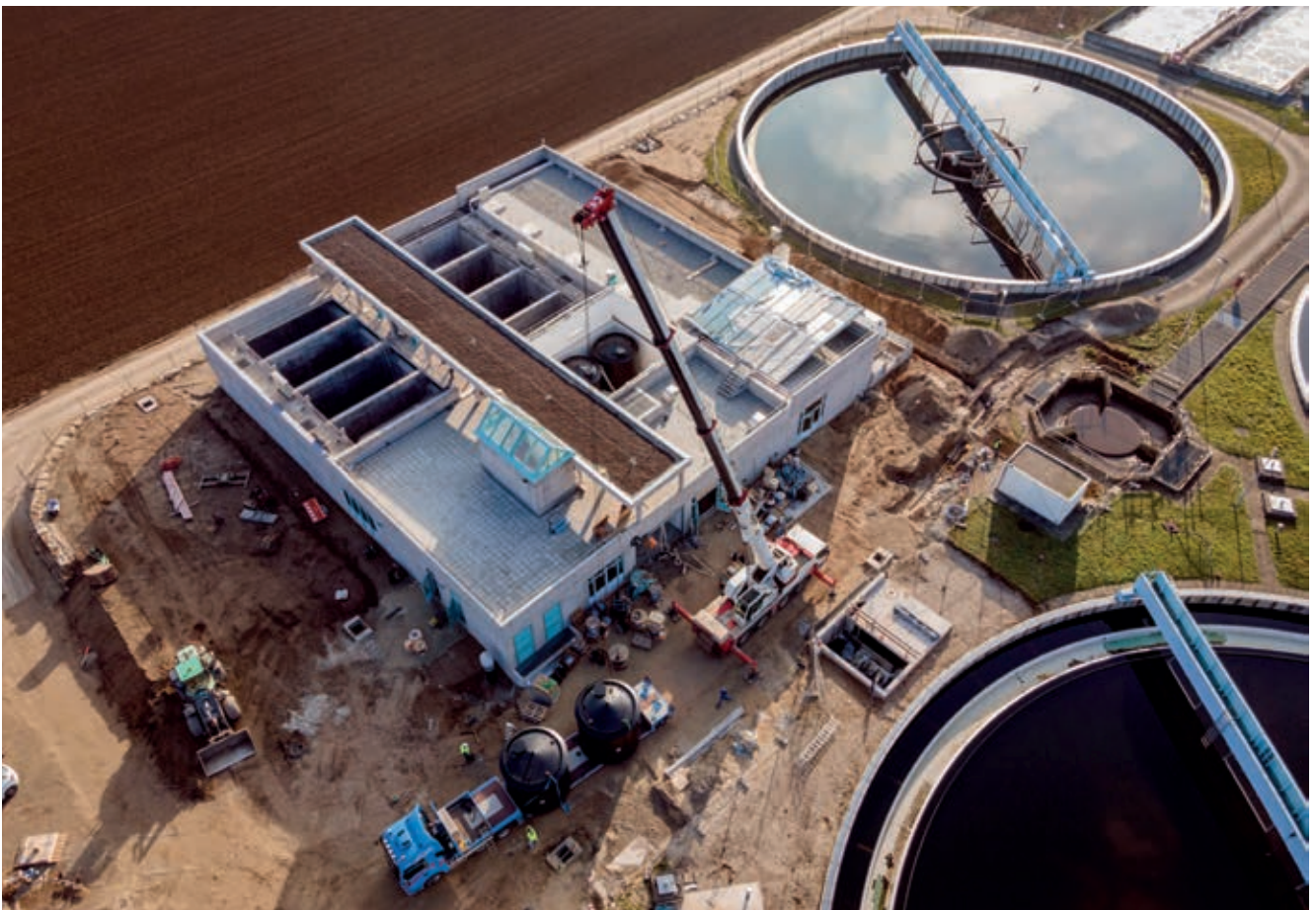
Bauarbeiten für die vierte Reinigungsstufe in der Tübinger Kläranlage. Bild: Die Kavallerie GmbH
