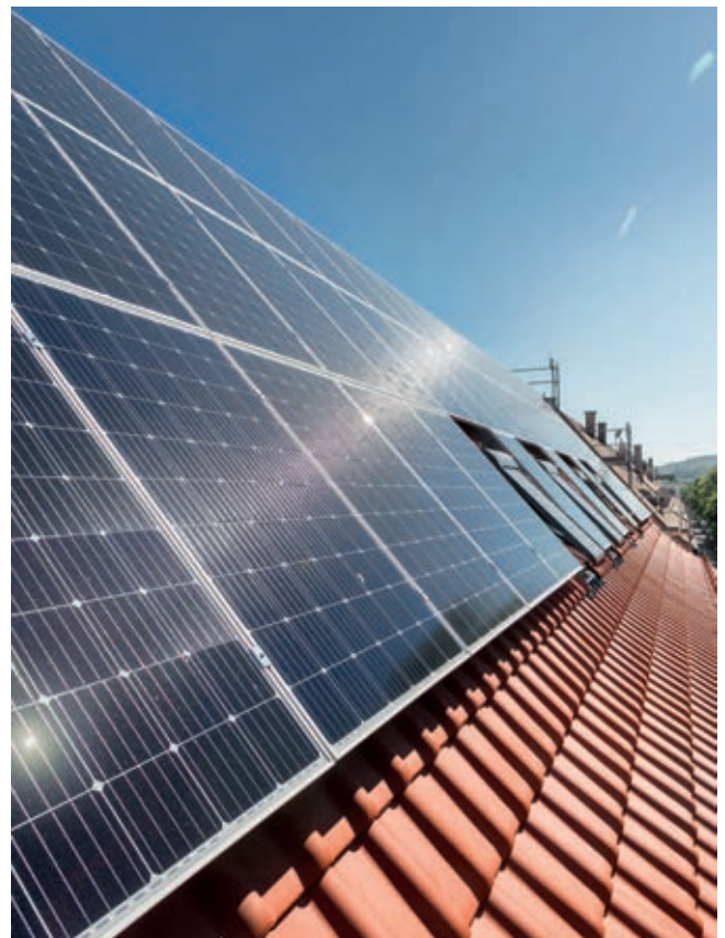
Die GWG Tübingen will bis 2030 klimaneutral werden. Ein Beitrag dazu ist das Photovoltaik-Ausbauprogramm, das die GWG gemeinsam mit den Stadtwerken Tübingen auf allen in Frage kommenden Dachflächen der GWG umsetzt – wie hier in der Schaffhausenstraße. Bild: GWG/Jürgen Lippert
