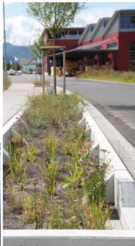
Rechts und unten: Bau einer Versickerungsanlage für beengte Verhältnisse: Verwendung eines durchlässigen Sickersubstrats, Bepflanzung mit heimischen Wildstauden. Gewerbegebiet Stollen, Gutach
