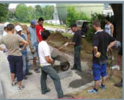
Der neue Bolzplatz fürs Quartier entstand am Tilsiter Weg oberhalb des Stadtwerke-Areals. Jugendliche aus den drei Höfen haben beim Bauen geholfen – das schützte den neuen Platz später auch ein Stück weit vor Vandalismus.
