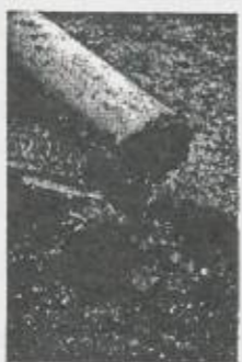
Vom Rost zerfressen – vom Wind auf Waldhäuser Ost verweht: Zwei Millionen müßten investiert werden, wenn – wie befürchtet – auch die anderen WHO-Masten bald fällig werden. Das Tiefbauamt hat nicht einmal das Geld, um diesem Verdacht gründlich nachzugehen. Privatbild
