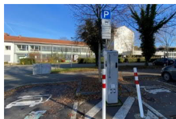
Abb. 33: Ladeinfrastruktur am Parkplatz Feuerhügge
