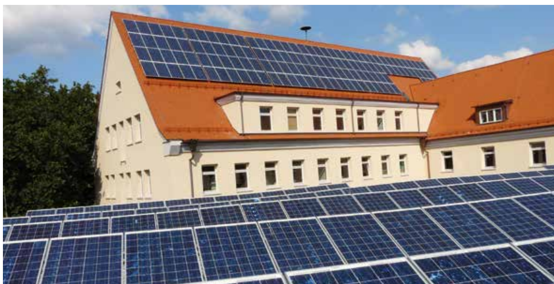
Bürger-PV-Anlage auf dem Wildermuth-Gymnasium.
