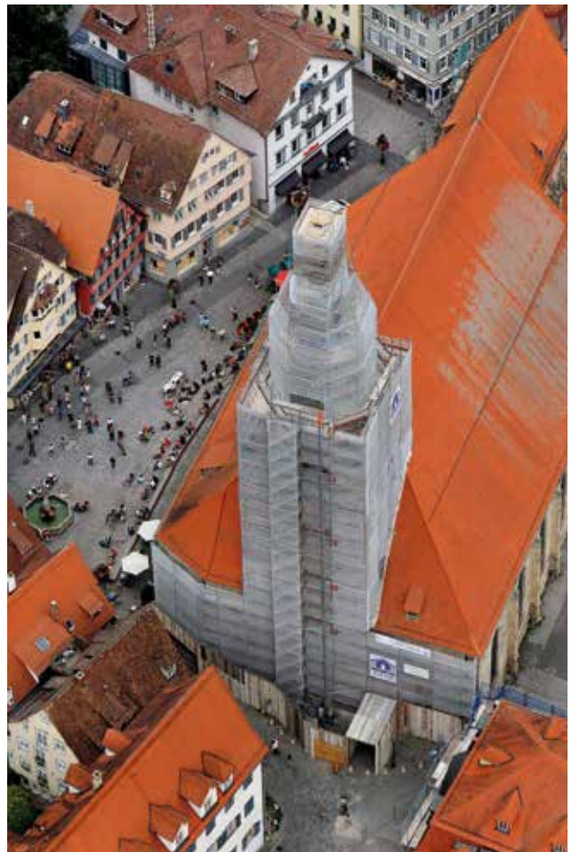
Im November 2012 ist die Sanierung der Stiftskirche abgeschlossen – das letzte Gerüst kann abgebaut werden. Die Spendenaktion „2 für 1“ der Universitätsstadt Tübingen hat die Instandsetzung möglich gemacht. Bild: Manfred Grohe
