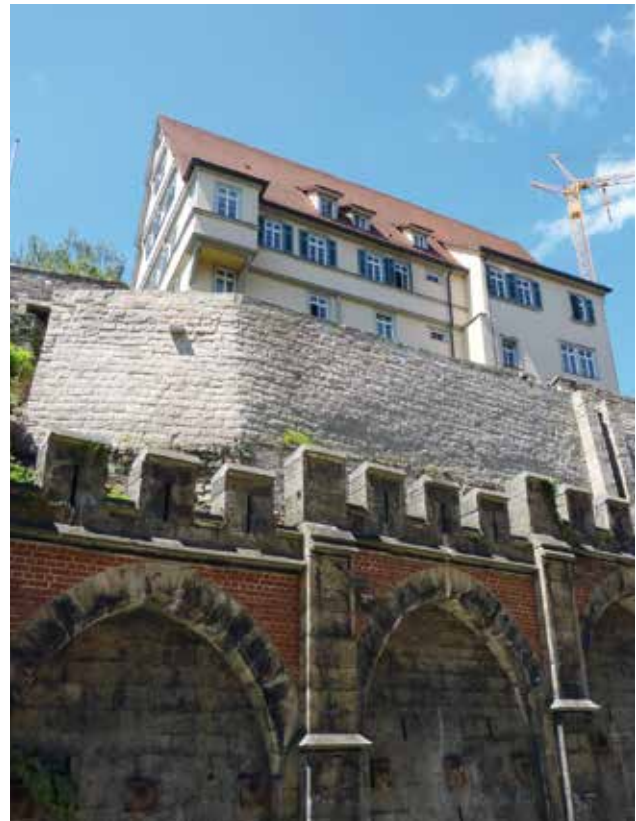
Die Stützmauern am Schulberg oberhalb der Mühlstraße wurden erneuert. Bild: Universitätsstadt Tübingen
