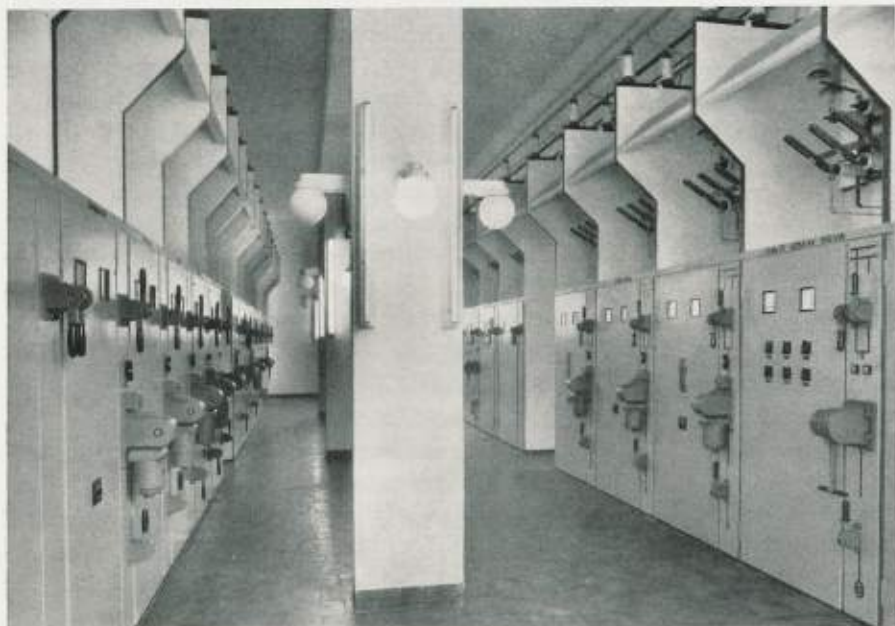
Hochspannungs-Schaltanlage des neuen Umspannwerkes in der Nonnengasse
