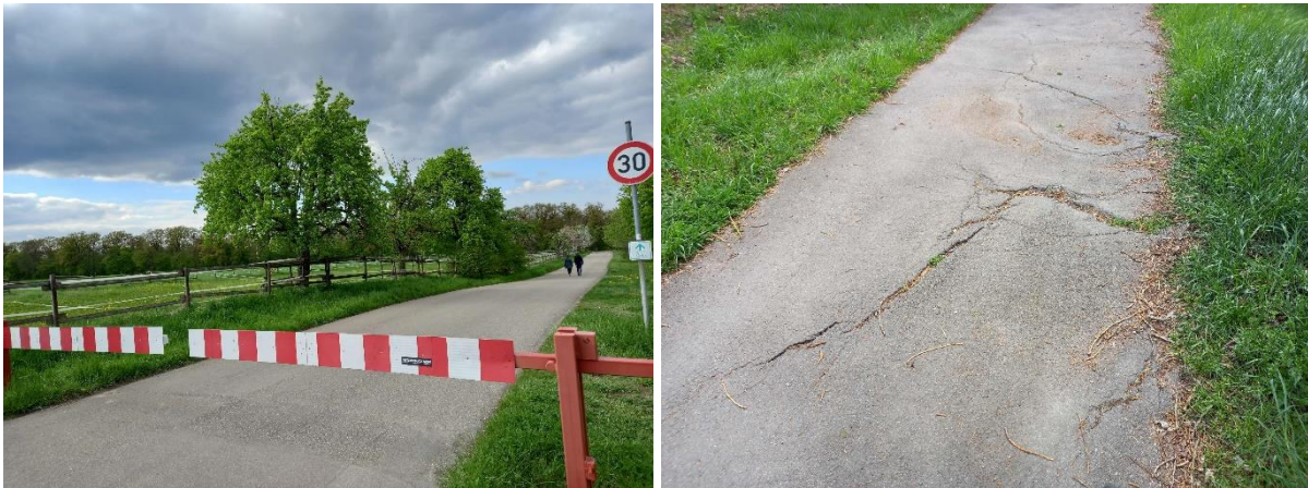
Abbildung 8 Beispielhafte Gefahrenstellen im Bestand (Quelle: INOVAPLAN GmbH)
