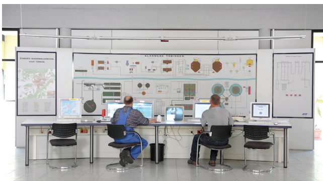
Leitwarte der Stadtentwässerung Tübingen
