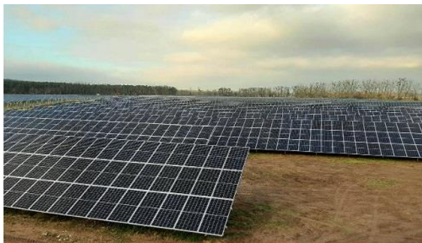
Solarpark "Metzdorf II"; Bild: swt
