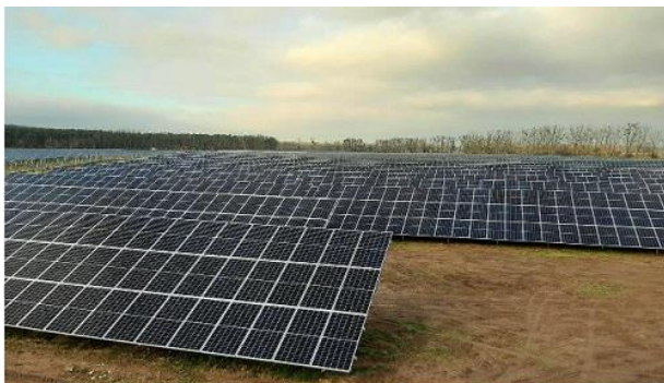
Solarpark "Metzdorf II"; Bild: swt
