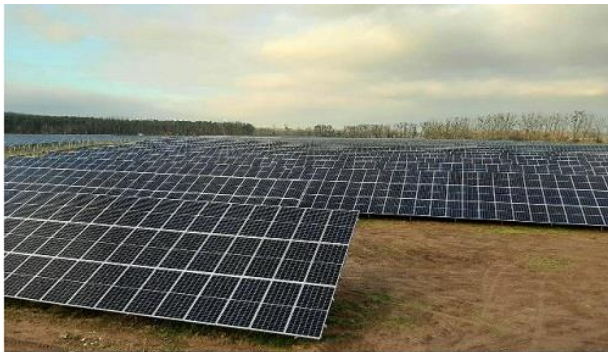
Solarpark "Metzdorf II"; Bild: swt
