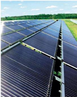
Bild: © Großanlage Senftenberg © Ritter Energie
