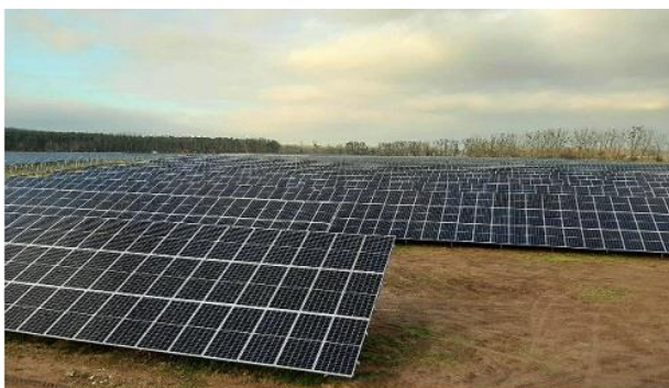
Solarpark "Metzdorf II"; Bild: swt
