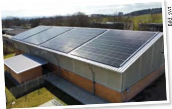
PV-Dachanlage auf der Sporthalle Holderfeld
